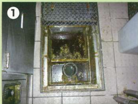
① グリストラップ洗浄前。油污れが排水口まで流れ出している。
